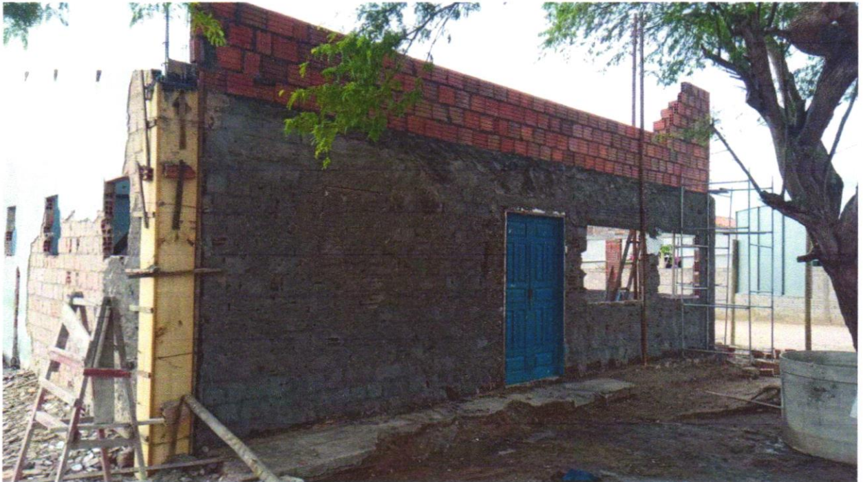
Foto 21 - CHAPISCO APLICADO EM ALVENARIA (COM PRESENÇA DE VÃOS) E ESTRUTURAS DE CONCRETO DE FACHADA, COM EQUIPAMENTO DE PROJEÇÃO. ARGAMASSA TRAÇO 1:3 COM PREPARO EM BETONEIRA 400 L. AF_06/2014
