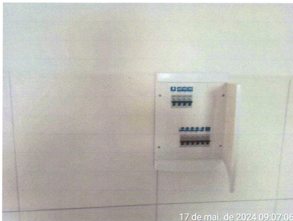
Foto 29 – QUADRO COM DISJUNTORES
