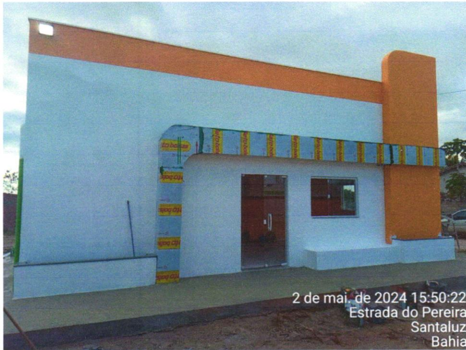
Foto 01 - Revestimento metálico em alumínio composto (Alucobond), e=0,3mm, pintura Kaynar 500 composta por seis camadas, inclusive estrutura metálica auxiliar em perfil de viga "U" de 2" - fornecimento e montagem
